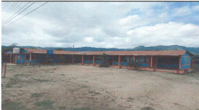
Foto1: EORM CASERIO LOS ANGELES, COMITANCILLO, SAN MARCOS, CUBIERTO DE LAMINAS DETERIORADAS. LADO NORTE Y OCCIDENTE.
